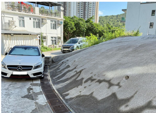
斜坡表面排水孔發現有滲水 (9月26日)
